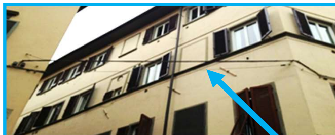
Cavo ottico in attraversamento
