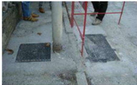
I pozzetti che ospitano le infrastrutture degli Enti e di TIM debbono necessariamente essere separati. Nella foto il pozzetto della pubblica illuminazione (a sx) e il pozzetto di TI (a dx)
