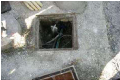
Pozzetto della pubblica illuminazione aperto con il transito all'interno dei 2 minitubi di TI
